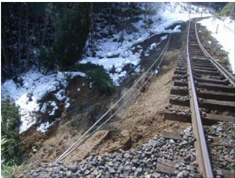
写真-1 盛土被災状況
