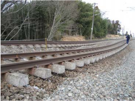
写真-2 検討対象盛土被災状況
