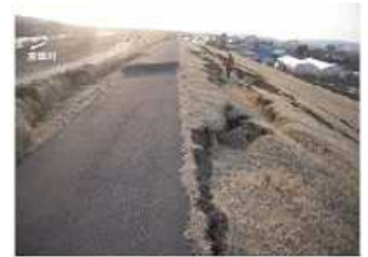
図-1 開口クラックの被害事例 1)
