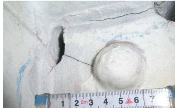
図-1 き裂発生状況
