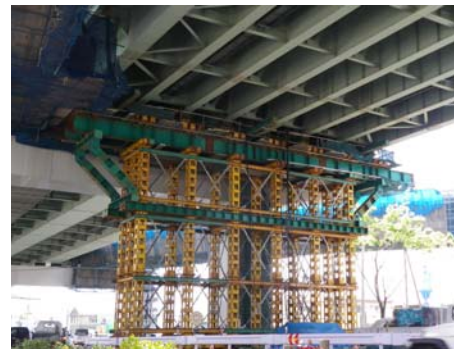
写真-4 P56 ベント設備
