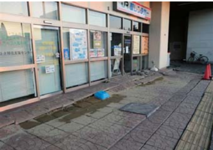
写真-1 古川駅前の噴砂状況
