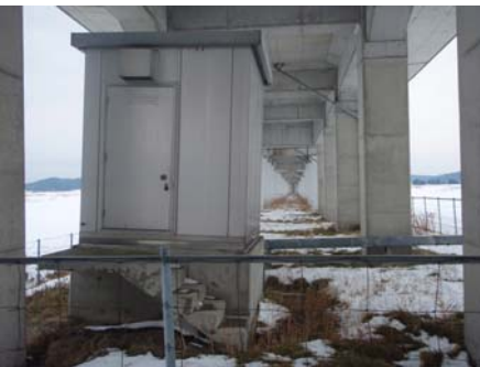
写真-3 高架下設備基礎の傾斜
