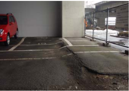
写真-2 古川駅高架下での地盤沈下
