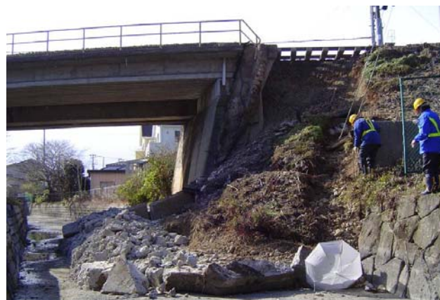
図-1 橋台翼壁の倒壊と橋台背面盛土の流出被害
