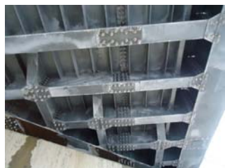
図-3 桁下の白錆発生状況
