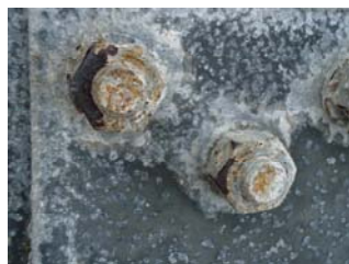
図-4 ボルト端部の錆
