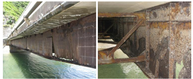
写真1 沿岸部橋梁桁内外の腐食状況
