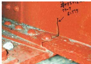
写真-1 桁端部の疲労亀裂
