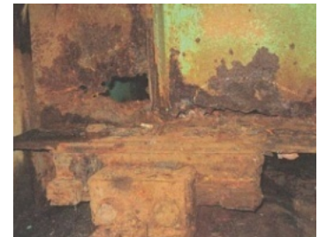
写真-2 桁端部の腐食
