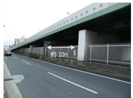
写真-1 損傷発生径間
