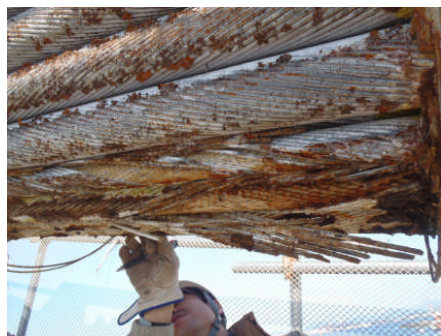
写真②. 主ケーブル素線破断部
