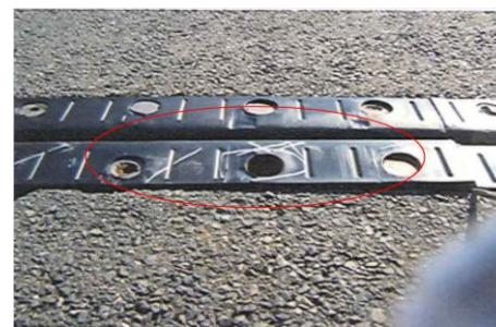
写真1 伸縮装置の損傷例（ボルト緩み）
