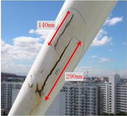
図-1 PE 管の割れと錆汁
