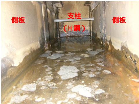
図-1 鋼製高欄内部の滞水・腐食状況
