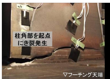
(A) 損傷状況
