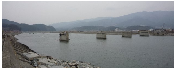
写真-1 気仙大橋被災後全景
