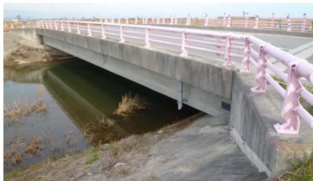
図-3 新川橋の被災
