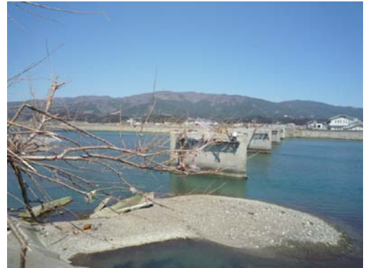
写真1 気仙大橋の被災状況
