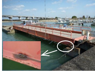
図1 局部腐食の例
