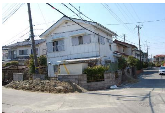
写真-1 液状化による戸建て住宅の不同沈下
