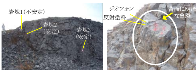
図11 測定斜面全景(左図)と不安定岩塊1(右図)
