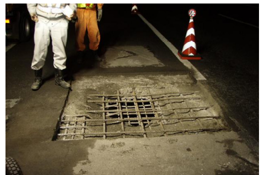
写真-1 抜け落ちた床版
