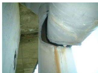
写真-2 分岐管の損傷
