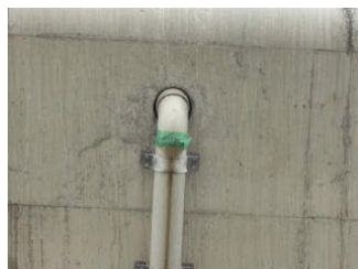
写真-1 接続部からの漏水
