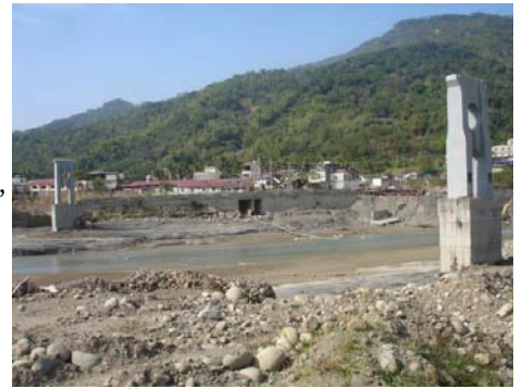
図5 落橋した吊り橋の洪水後の状況
