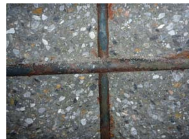
写真-3 腐食状況
