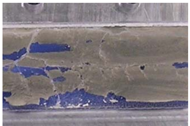
写真 3 低アルカリ性セメントの流出状況
