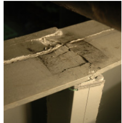
写真-3 破壊状況 (I300×2)
