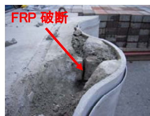
写真-1 FRP破断状況
