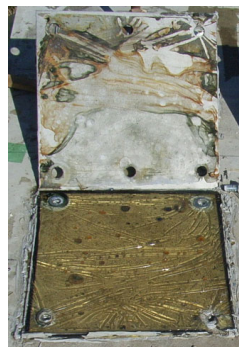
a) 樹脂と鋼板間剥離
