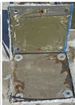
b) 樹脂とコンクリート間剥離
