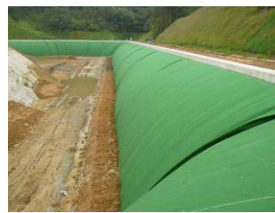
図-5 遮水シートの膨らみ
