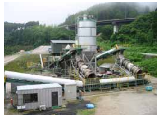
写真-1 CRT ミキサシステムの全景
