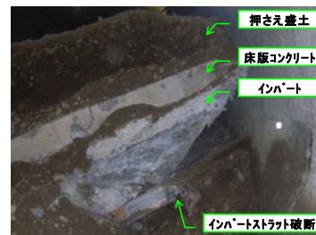
写真-2 路盤隆起部近景
