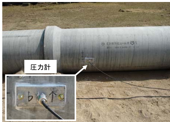
図5 圧力計設置状況
