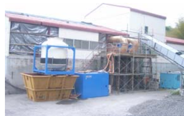
写真-1 骨材貯蔵庫冷却設備
