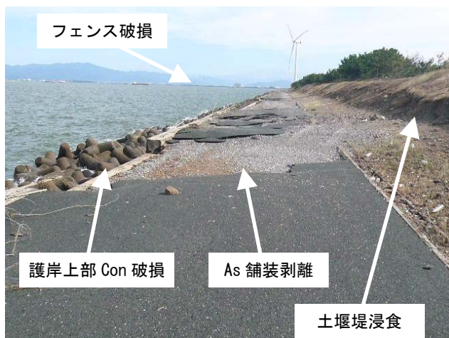
写真 2-1 護岸の被害状況
