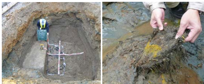
写真 3-2 護岸の変状 2 (吸出防止シートの破れ)
