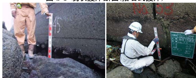
写真 3-1 護岸の変状〈護岸下部の隙間〉
