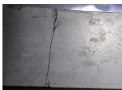
写真-3 ひび割れ幅
