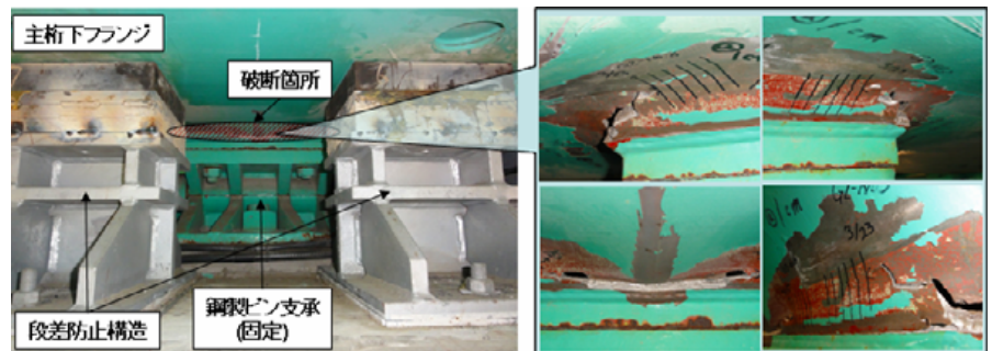
写真-2 損傷状況
