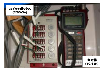
③計測システム
