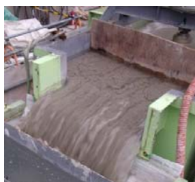
フロック生成状況(攪拌槽出口)
