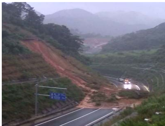
写真-1 斜面崩壊による被災直後例
