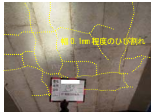
写真-4 床版ひびわれ
