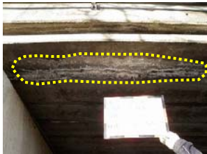
写真-3 漏水・遊離石灰 (c) その他の部位の損傷
