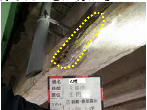
写真-5 漏水・遊離石灰
