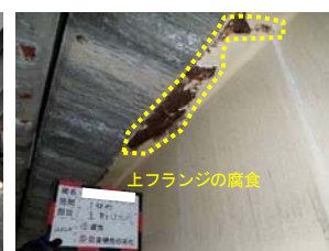
写真-2 鋼桁の腐食
