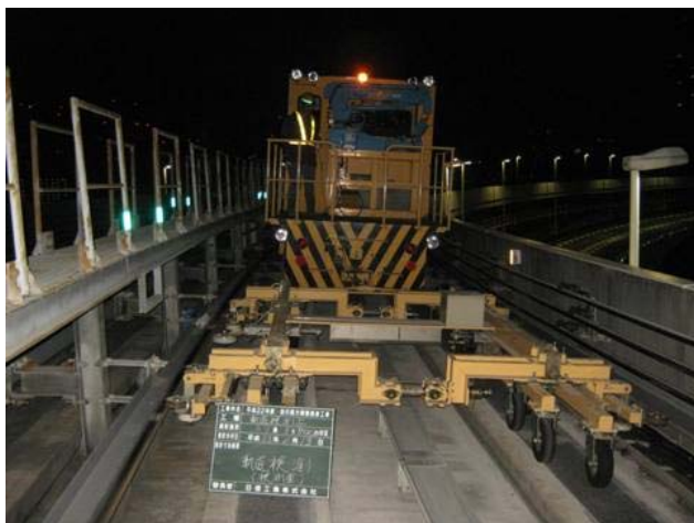
写真-3 線路測定車
