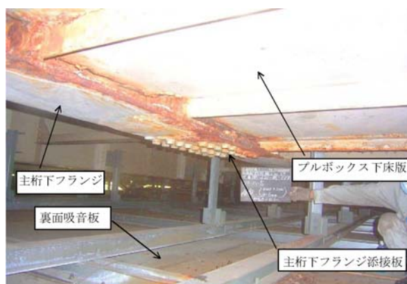
図-2 主桁ウェブ及び下フランジの断面欠損
