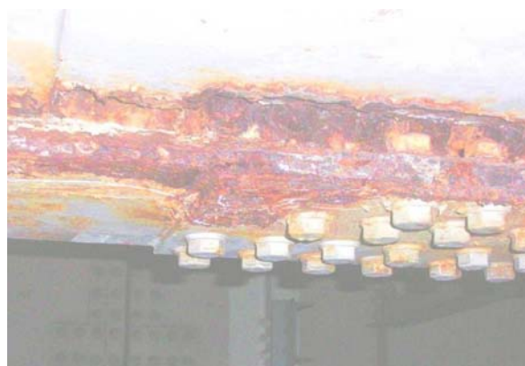
図-3 主桁下フランジ添接部腐食状況
