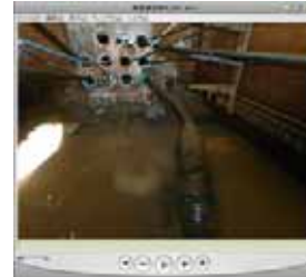
図-5 地震による被災人孔内部の撮影例
