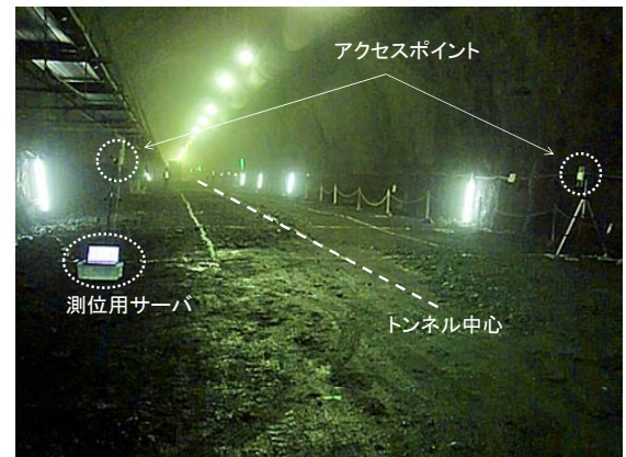
図-2 機器設置状況
