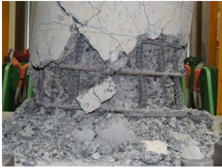
写真-1 損傷状況① (K1 (12δ y ))
