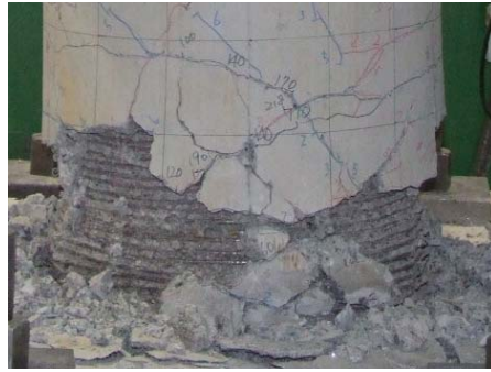
写真-2 損傷状況② (K6 (18δ y ))
