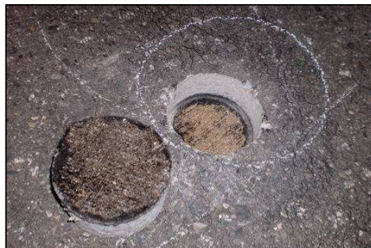
図4. 防水シートと床版面の剥離
