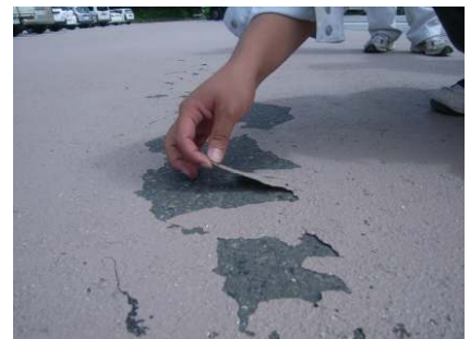
写真-1 剥離状況
