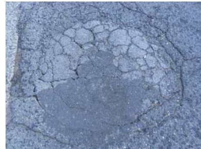
図1 局部的なひび割れ損傷状況
