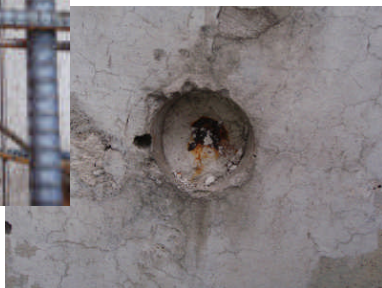
写真-2 モルタル部落下状況
