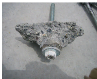
写真-8 突起上部で躯体破断
