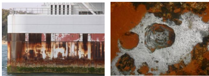
(a)腐食状況 (b)孔食状況 写真-1 鋼ケーソンの現状
